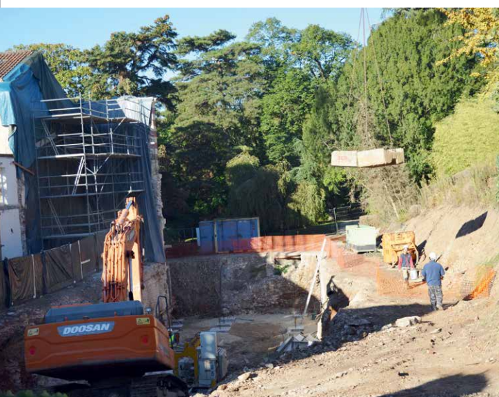
La grande fosse qui marque les bases de la fondation de l'extension.
